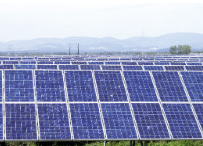
Solarkraftwerk mit Silizium-Solarmodulen
